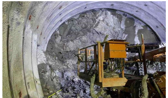
11月8日長野県 豊丘村 坂島工区 斜坑トンネルの事故現場
