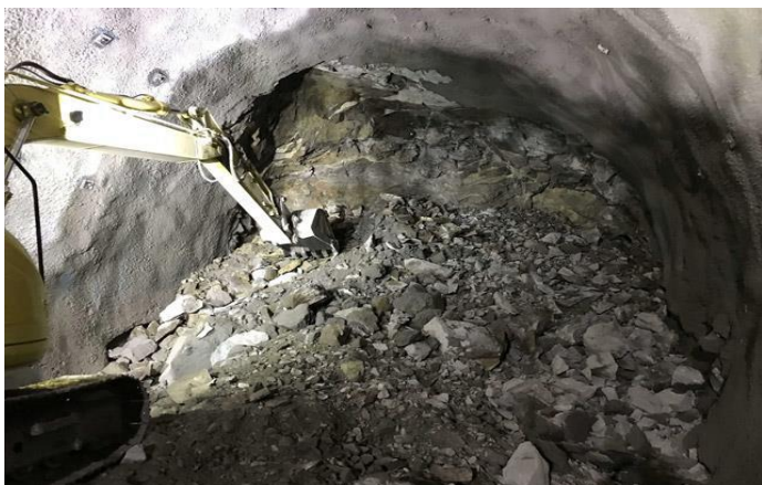
2021年10月27 瀬戸非常口斜坑崩落 (肌落ち)現場写真
