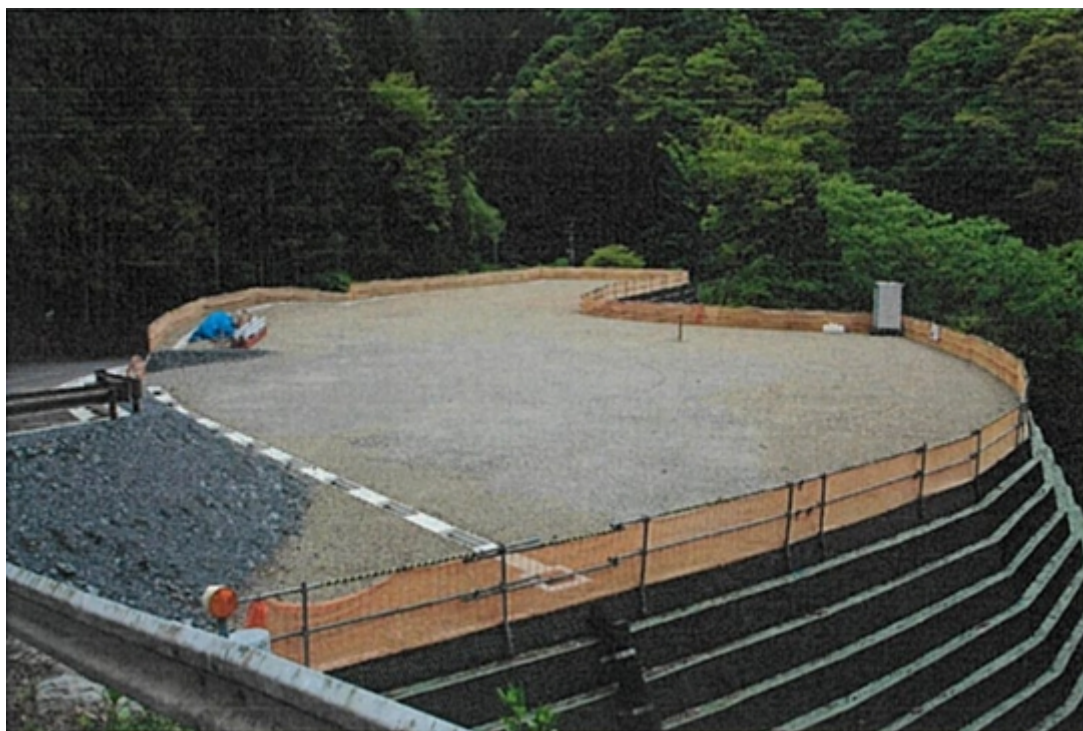
図１５ 旧荒川荘跡地のほぼ垂直に近い法面（甲ＣＮ第２７号証の⑤）
