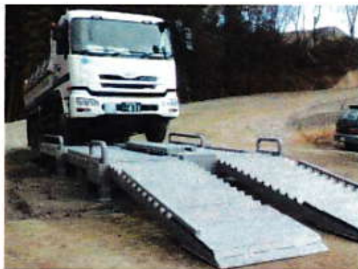
タイヤ清掃設備
