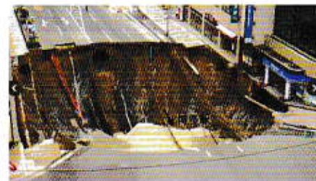
2016年11月8日 博多の道路陥没事故
